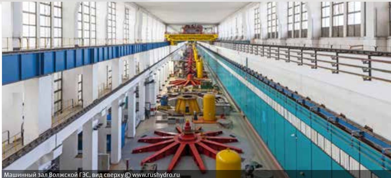
Машинный зал Волжской ГЭС, вид сверху © www.rushydro.ru
